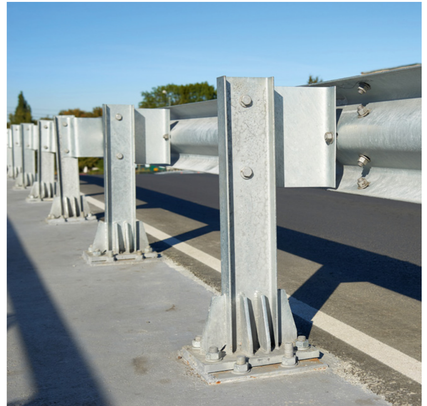
Решение 4. Монтаж стоек дорожного металлического ограждения барьерного типа (мостовая группа) ГОСТ 26804-2012 в условиях отрицательных температур (до -10°C)
